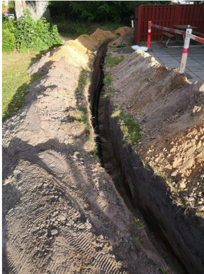
Fjernvarme til Vrøgum
