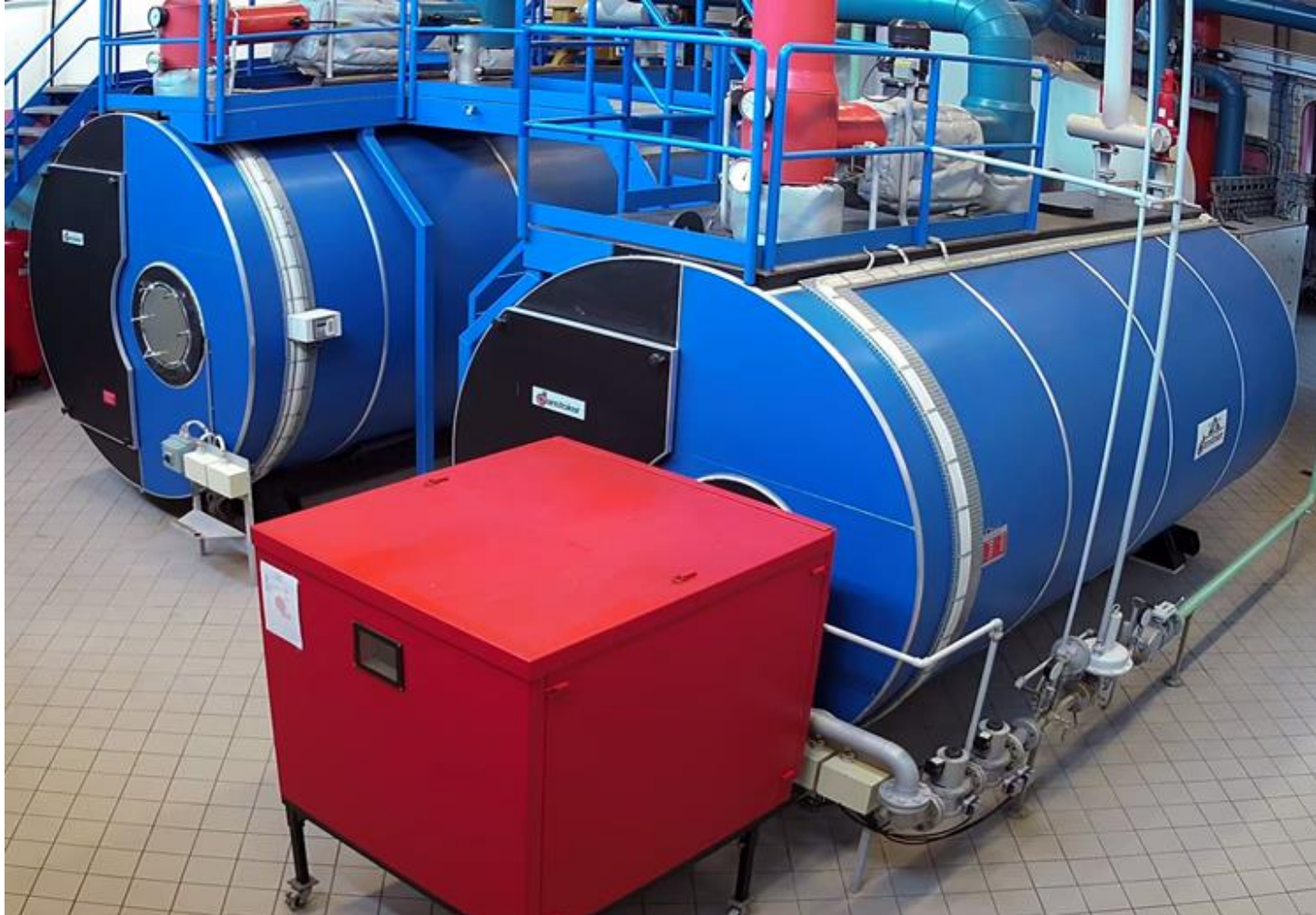
Fjernvarme til Vrøgum
