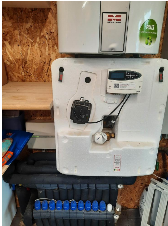
Fjernvarme til Vrøgum
