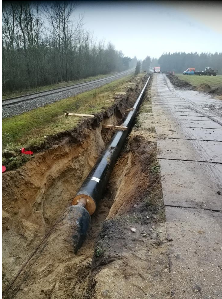
Fjernvarme til Vrøgum
