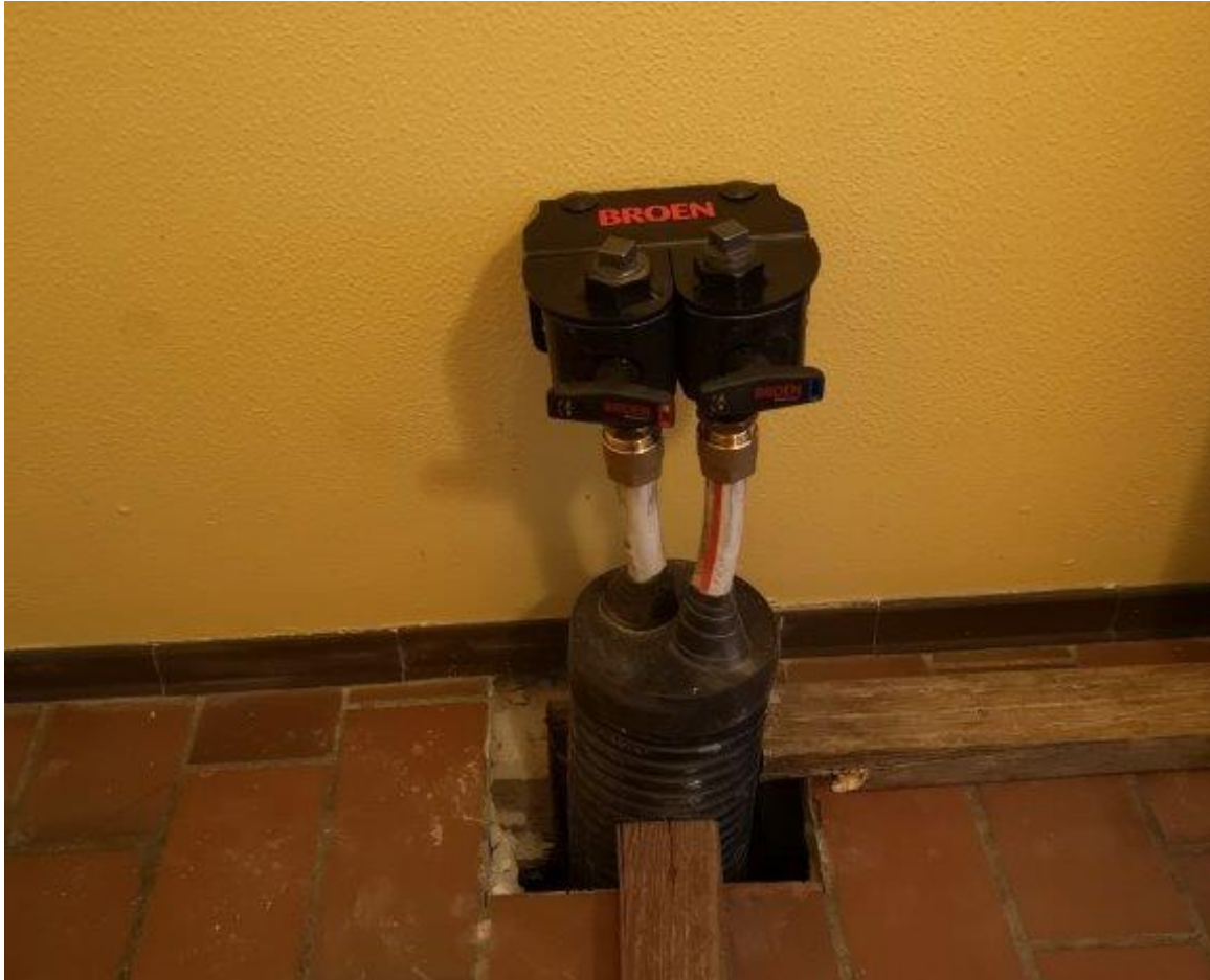
Fjernvarme til Vrøgum
